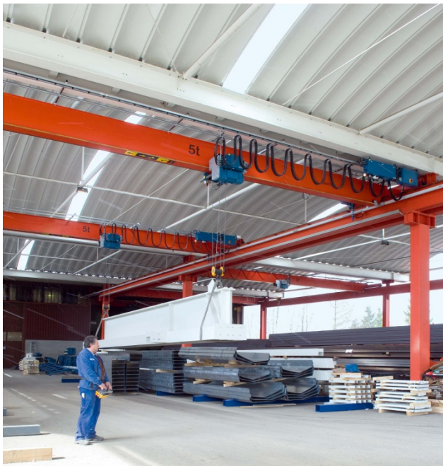
1 Krane dürfen nur in betriebs-sicherem Zustand eingesetzt werden.
